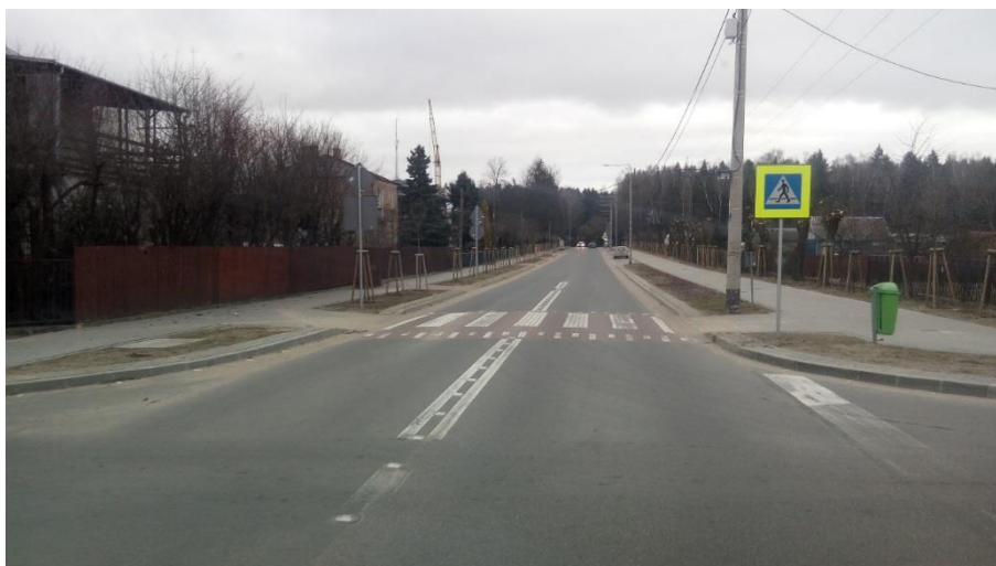
Rysunek 23 Droga powiatowa nr 2360B ul. Aleja Niepodległości w Mońkach. Nowa nawierzchnia bitumiczna wraz z elementami bezpieczeństwa ruchu drogowego
