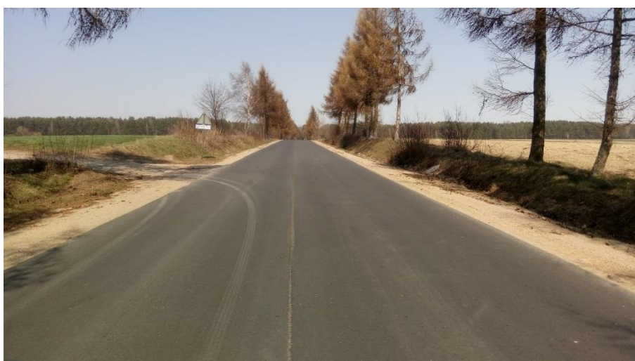
Rysunek 25 Droga powiatowa nr 1412B odcinek przed miejscowością Rutkowskie Duże. Nowa nawierzchnia bitumiczna wraz z pobocznymi z kruszywa naturalnego
